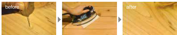
凹み傷がついたフローリング(スギ)
